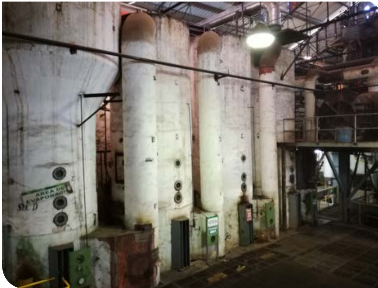
Beneficios por cambios en evaporadores: Estación de evaporación
