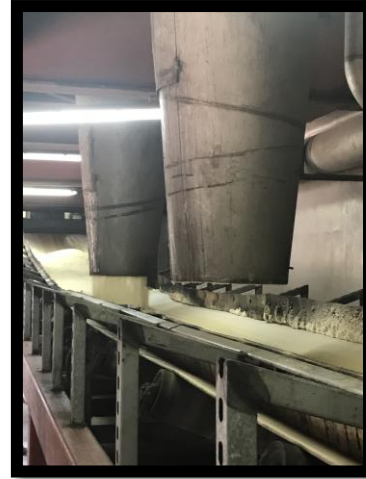
Figura 29. Descarga de centrífugas
